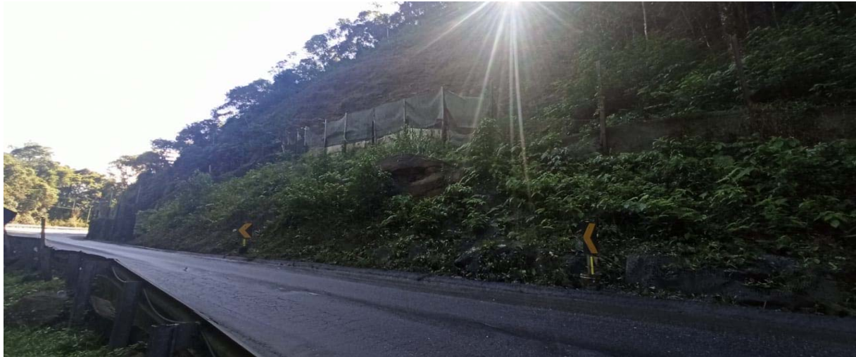
Figura 11 – Escorregamento de Talude em Cachoeiras de Macacu - Km 53,5. Foto de: 15/06/2021. [1]
