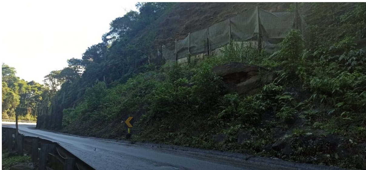
Figura 14 – Escorregamento de Talude em Cachoeiras de Macacu - Km 53,5. Foto de: 15/06/2021. [4]
