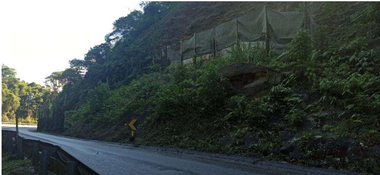
Figura 12 – Escorregamento de Talude em Cachoeiras de Macacu - Km 53,5. Foto de: 15/06/2021. [2]
